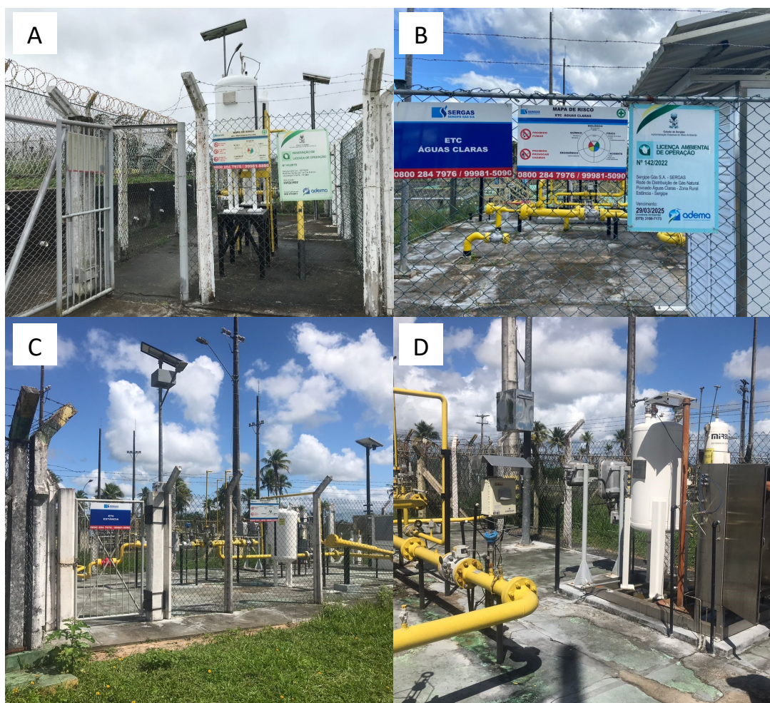
Figura 1 : Manutenção preventiva das Estações
