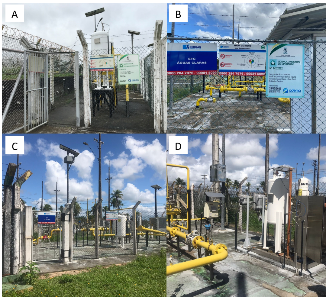
Figura 1 : Manutenção preventiva das Estações
