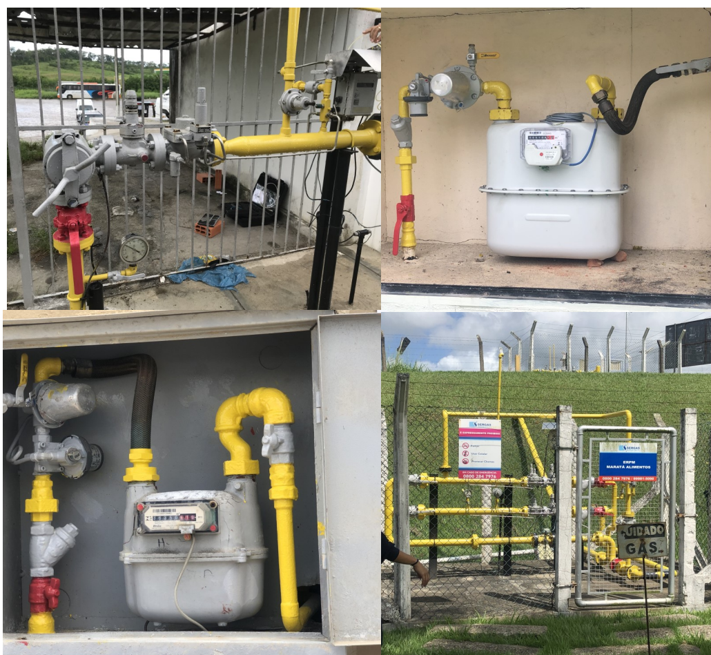
Figura 1: Manutenção preventiva das Estações e CRM'S
