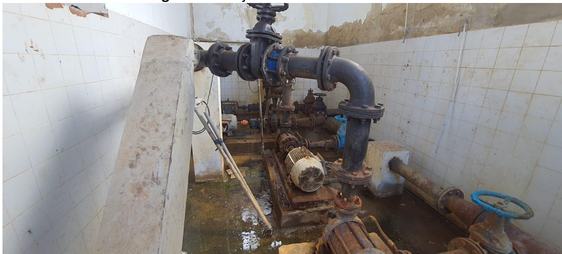
Imagem 4 – Conjuntos motobombas da EEAT.
