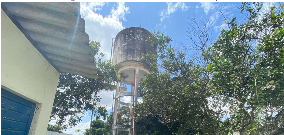
Imagem 1: Área dos Reservatórios Elevado – sede municipal.
